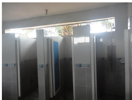
Renovierte und funktionierende Duschanlagen
